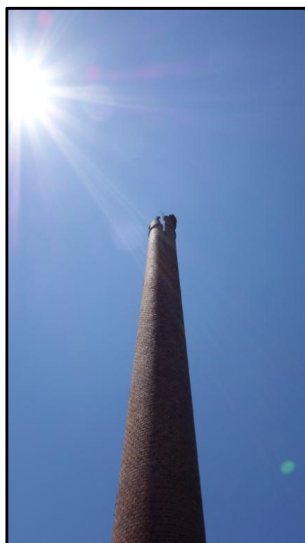
Detalle del estado de la salida de humos de la chimenea.
